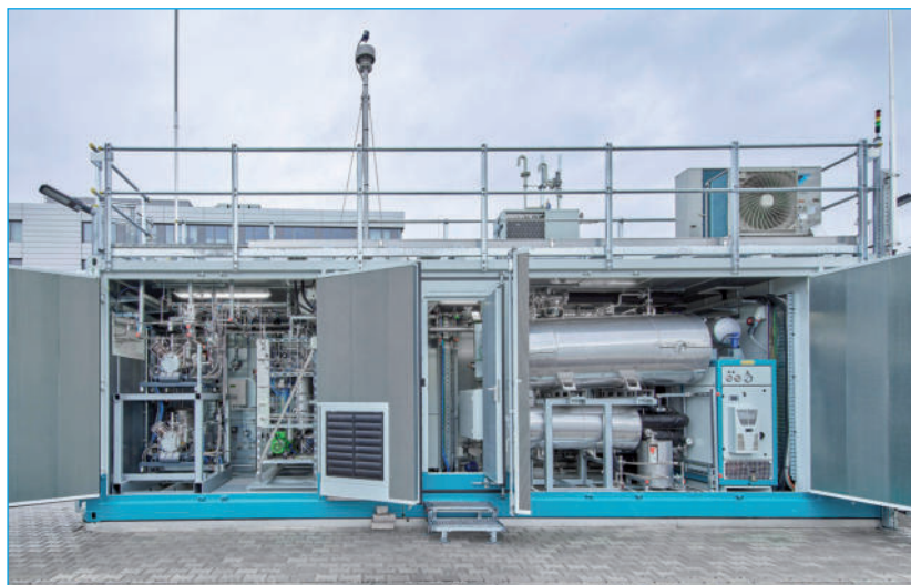
Abb. 4: Freisetzungsanlage von Wasserstoff der Fa. Hydrogenious LOHC Technologies an der Wasserstofftankstelle in Erlangen ■
